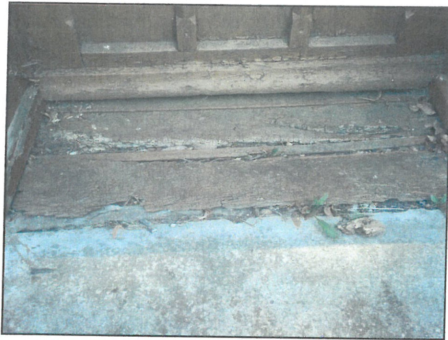
Fot. 23 Uszkodzony próg przed drzwiami północnymi
