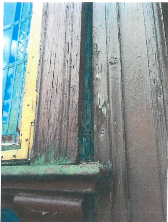
Fot. 15 Fragment skorodowanej stolarki okiennej
