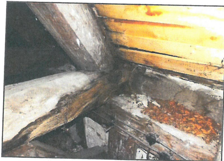
Fot. 30 Skorodowana końcówka belki
