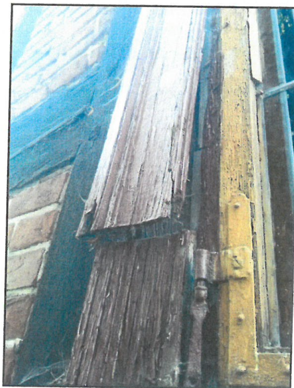
Fot. 24 Uszkodzenie obramienia okiennego
