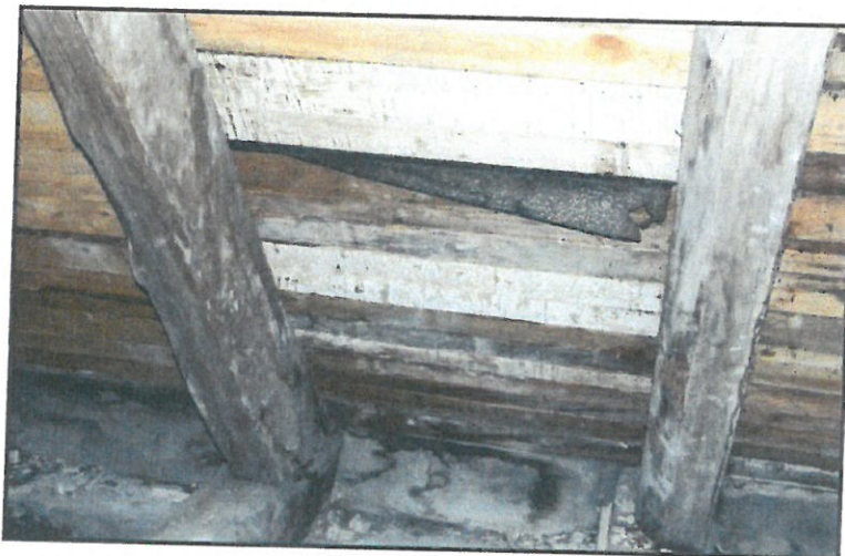
Fot. 31 Uszkodzenie zawilgoconego deskowania- prowizoryczne uzupełnienia
