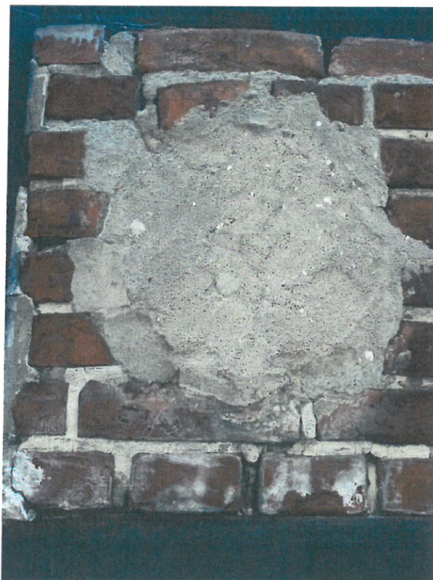
Fot.8 Uszkodzenie ceglanego wypełnienia konstrukcji szachulcowej-zaprawa cementowa
