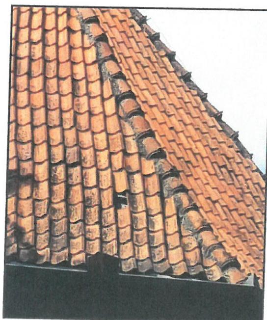
Fot. 26 Ubytek dachówki, gąsiory mocowane na zaprawie cementowej
