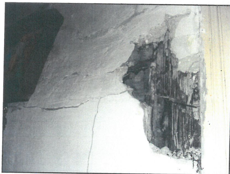
Fot. 34 Uszkodzenia ściany wewnętrznej- strona południowa elewacji zachodniej
