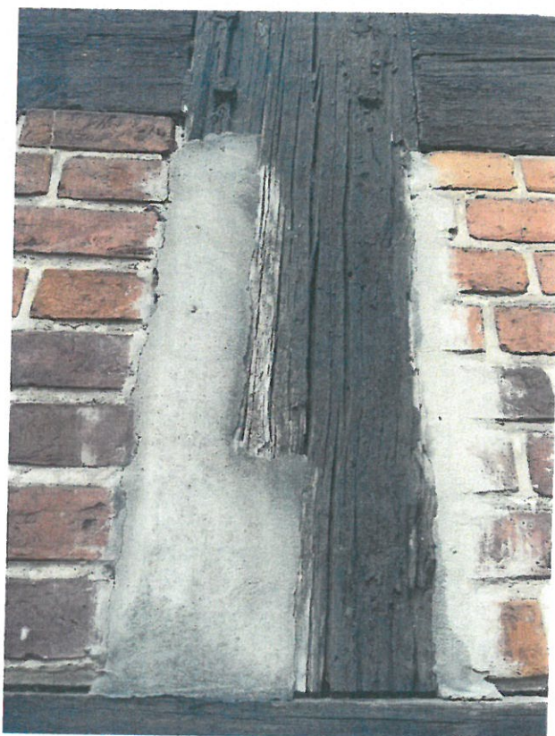
Fot. 10 Prowizorycznie naprawione ubytki słupa konstrukcji szachulcowej
