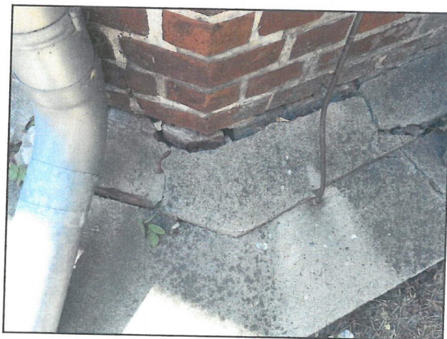
Fot. 9 Spękanie odsadzki betonowej przy cokole
