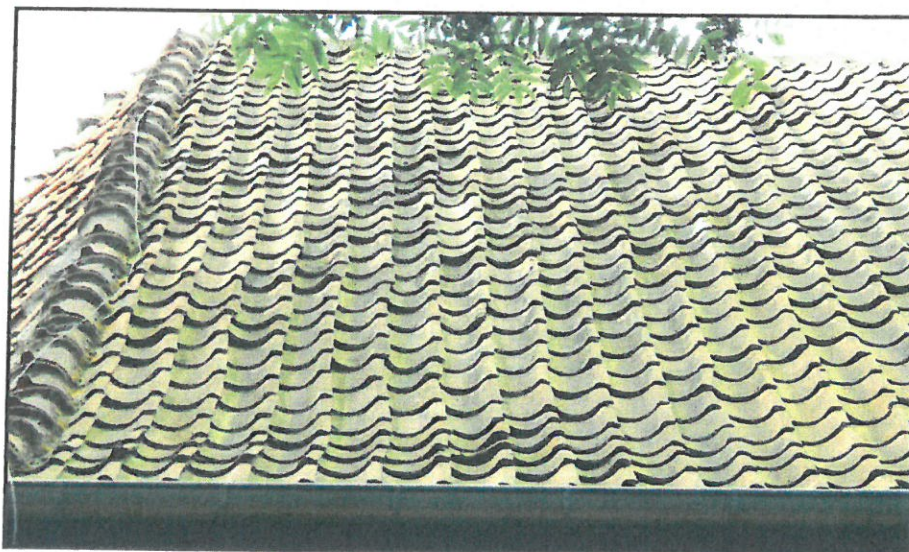
Fot. 27 Skorodowana i zanieczyszczona dachówka
