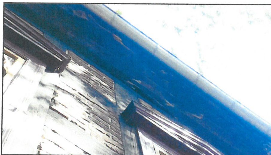
Fot. 22 Zawilgocone i uszkodzone deski okapowe- elewacja zachodnia
