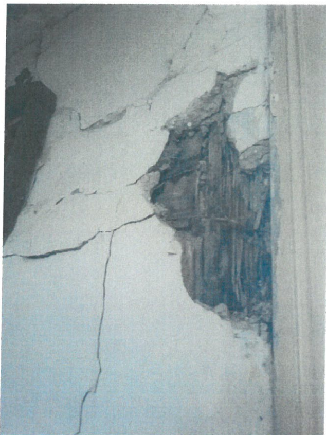
Fot. 31 Uszkodzenie tynków wewnętrznych
