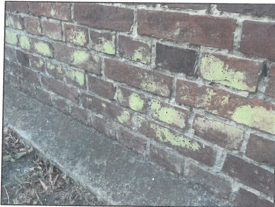
Fot. 7 Porażenie biologiczne ceglanego cokołu
