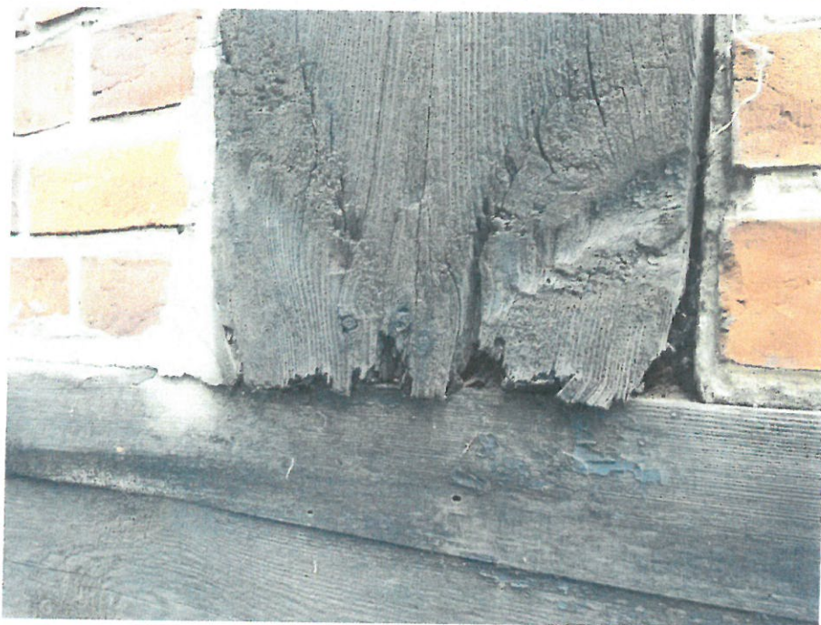
Fot. 9 Skorodowana końcówka słupa konstrukcji szachulcowej
