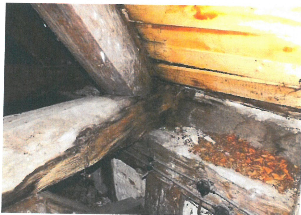
Fot. 30 Skorodowane elementy więźby dachowej
