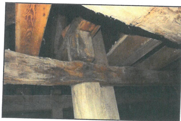
Fot. 32 Skorodowane elementy konstrukcji wieżyczki
