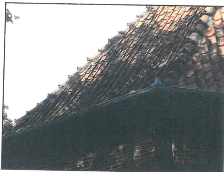
Fot. 25 Skorodowana i poluzowana dachówka i skorodowane gąsiory mocowane na zaprawie cementowej
