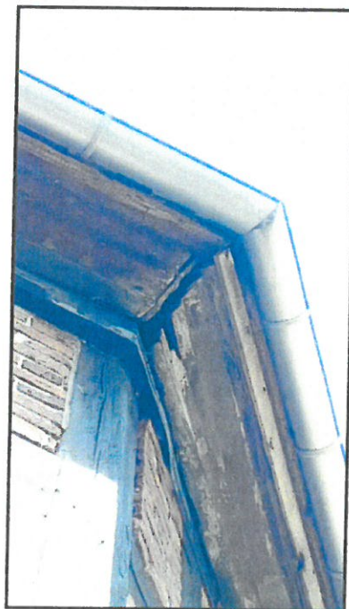
Fot.20 Uszkodzenie desek okapowych w narożniku południowo- wschodnim
