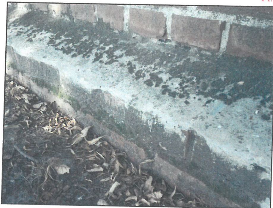
Fot. 8 Betonowy cokół- porażenia biologiczne
