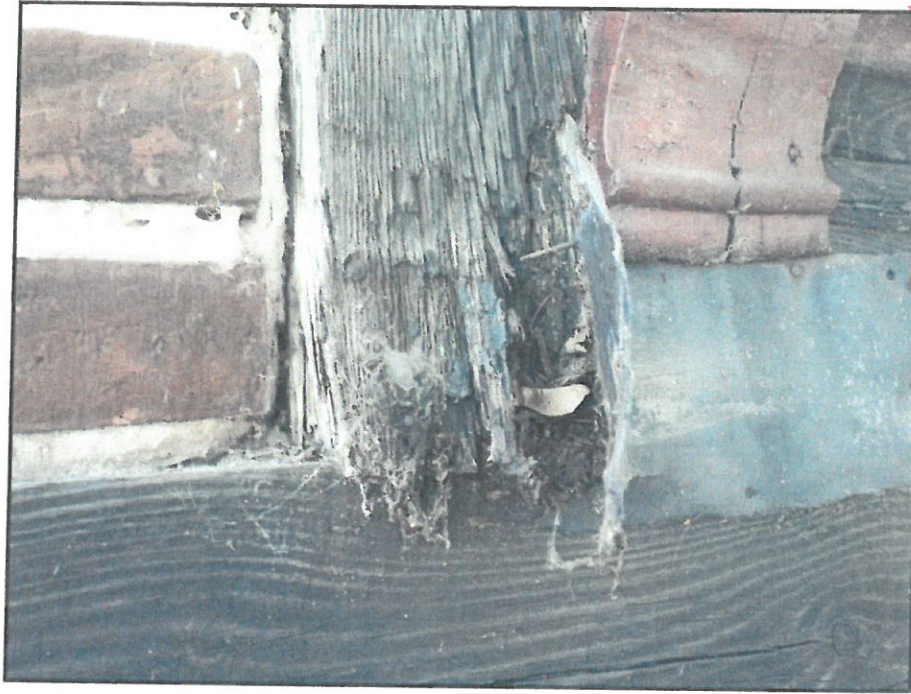
Fot. 15 Skorodowana końcówka słupa
