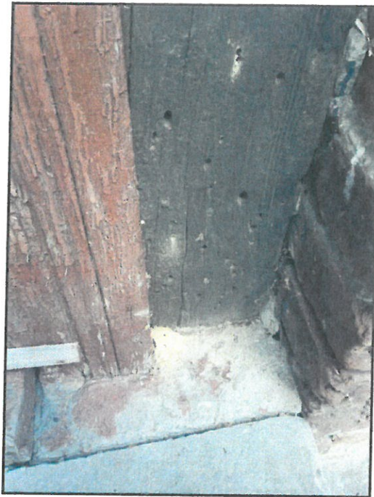
Fot. 19 Korozja biologiczna słupa drewnianego- widoczna aktywność szkodników drewna
