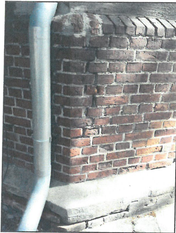
Fot. 10 Wypłukane spoiny, uszkodzenie narożnika
