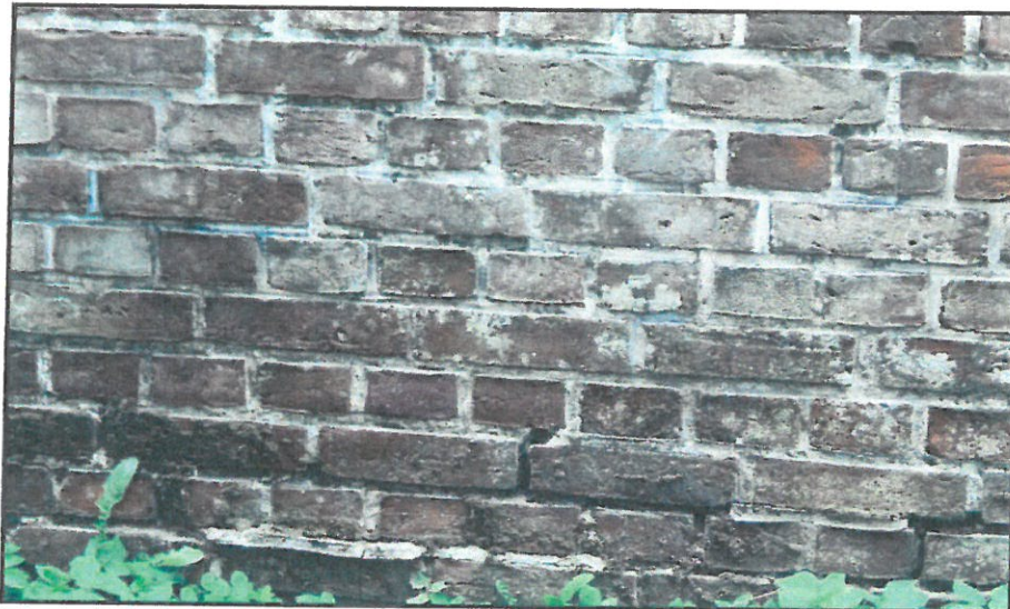
Fot. 6 Zawilgocenie i porażenia biologiczne cokołu
