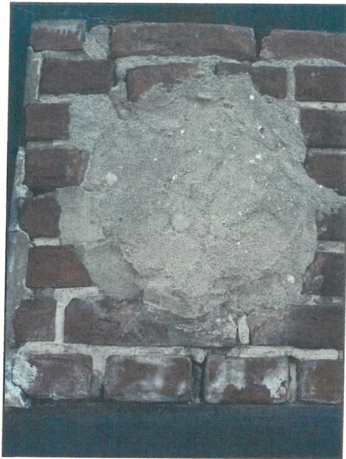
Fot. 14 Uszkodzenie ceglanego wypełnienia konstrukcji ryglowej zaprawione cementem
