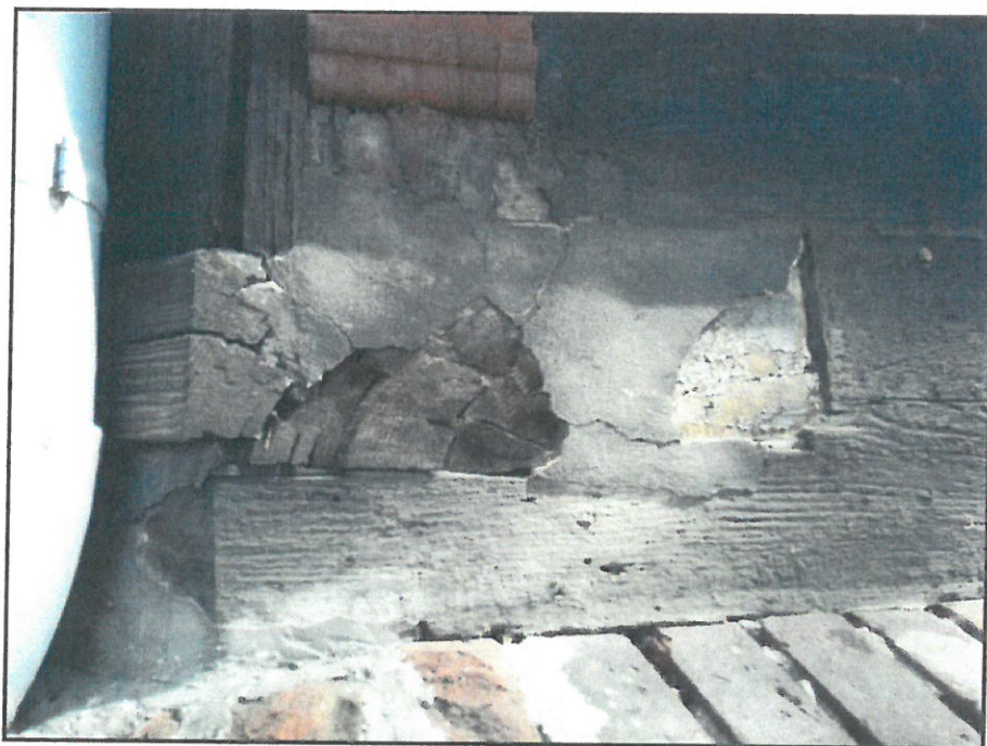
Fot. 18 Uszkodzenie belki podwalinowej
