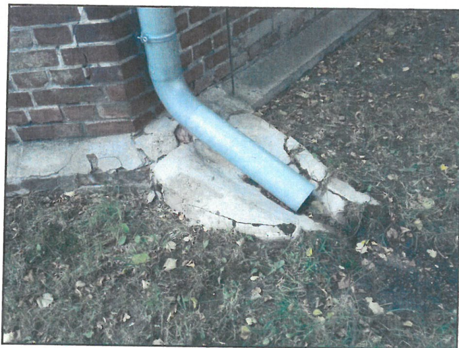
Fot. 28 Istniejące wyprowadzenie wód opadowych z rury spustowej
