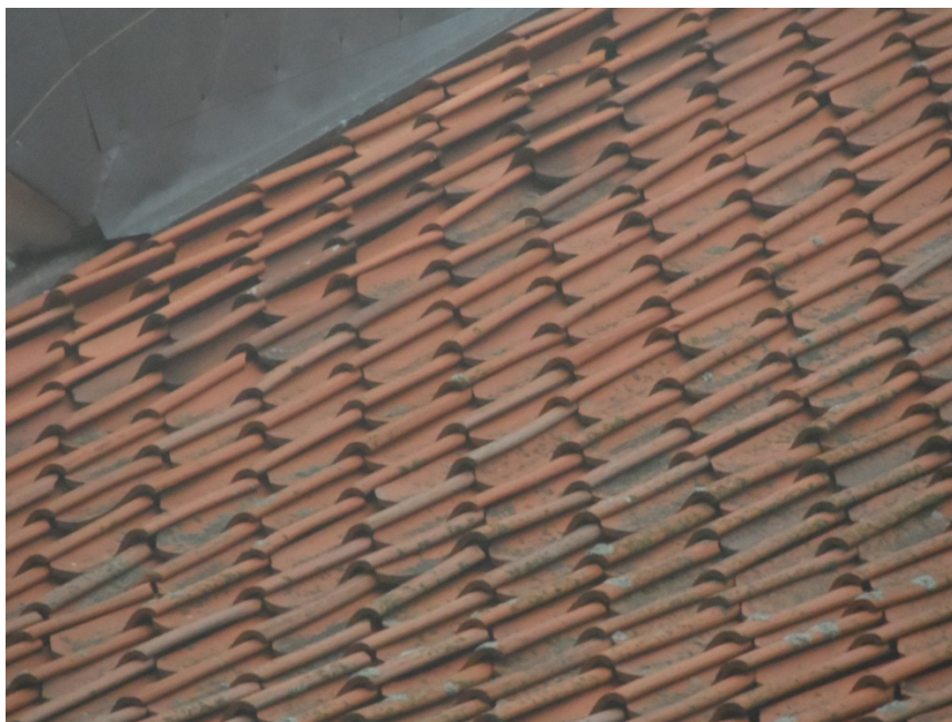
Widoczna deformacja pokrycia dachówkowego
